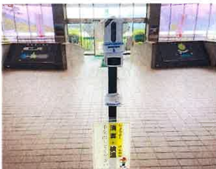
消毒・検温機を設置
